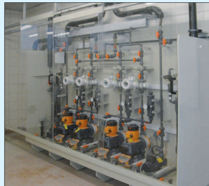
Dosieranlage mit vier Strängen
