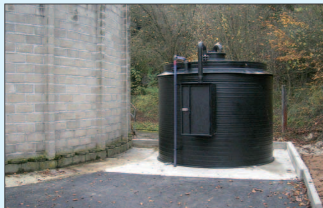
Lager- und Dosieranlage Fällmittel
