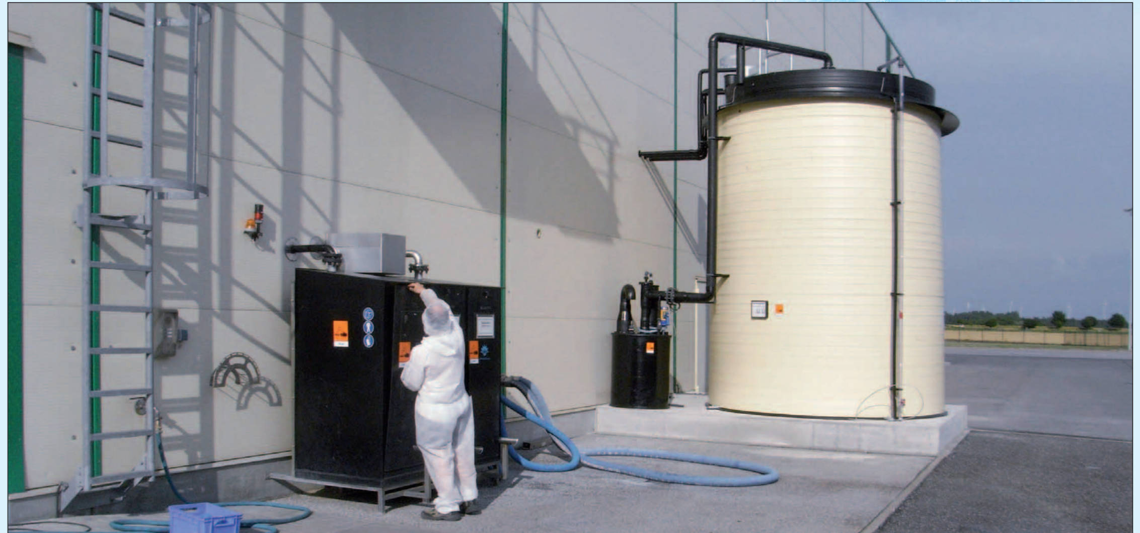
Abfüll- und Lageranlage für Salzsäure mit Abluftwäscher
