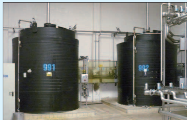
CIP-Anlage in der Molkerei (NaOH + HNO 3 )
