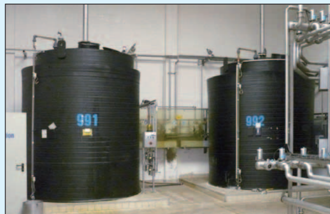
CIP-Anlage in der Molkerei (NaOH + HNO 3 )
