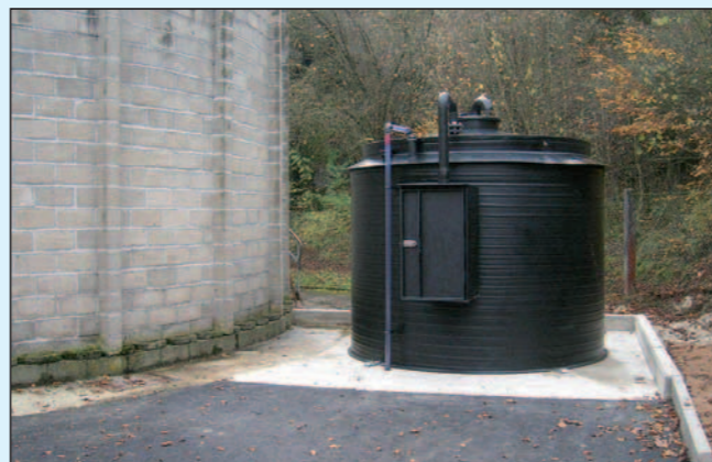
Lager- und Dosieranlage Fällmittel
